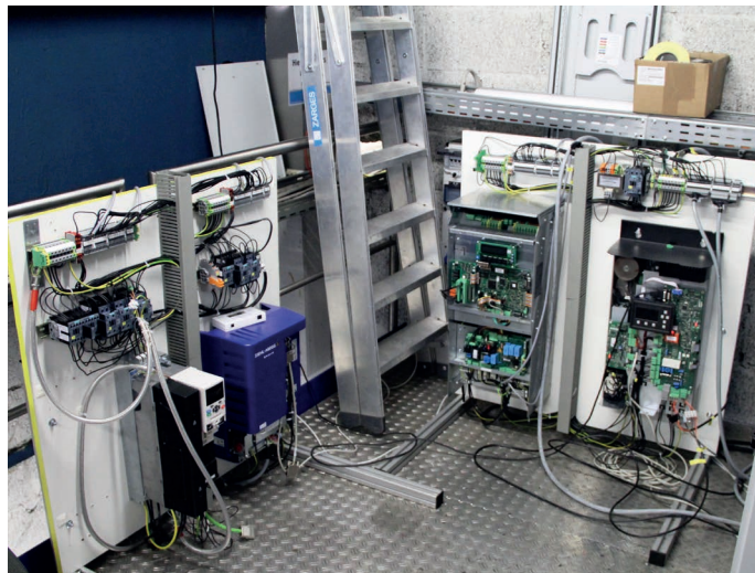
Bild 4: Prüfaufbau für die Umrichter
