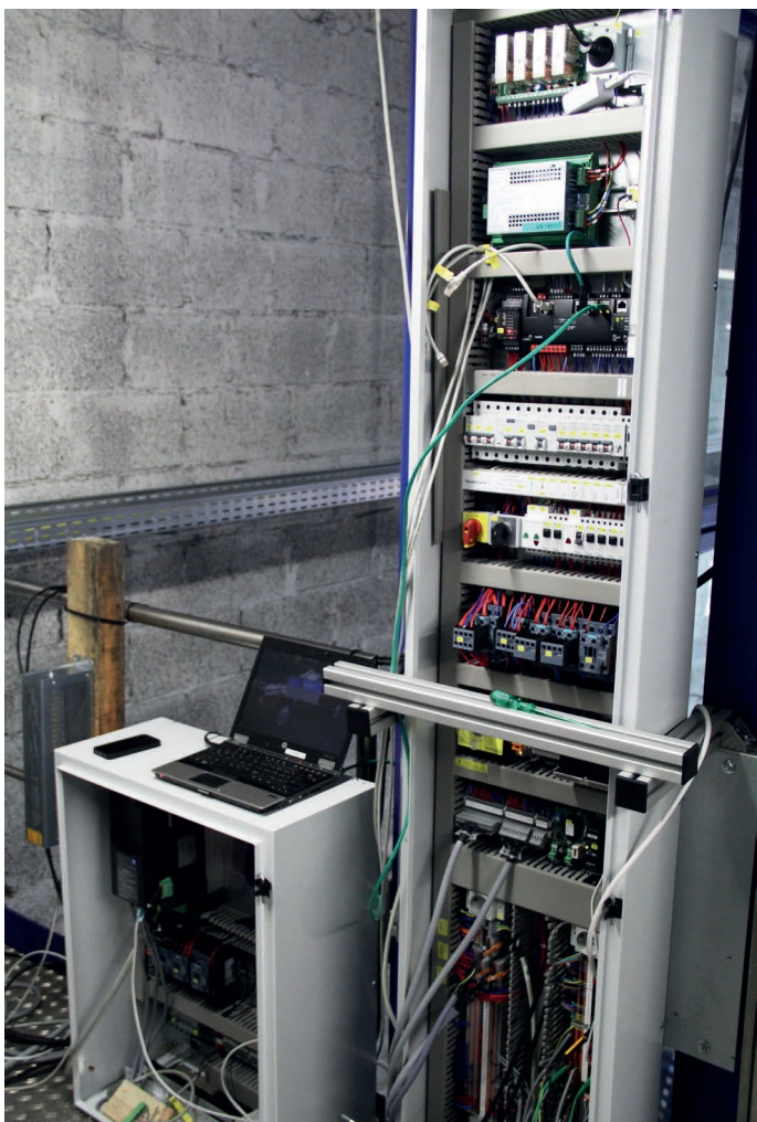
Bild 3: Prüfaufbau der Steuerung an der Musteranlage
